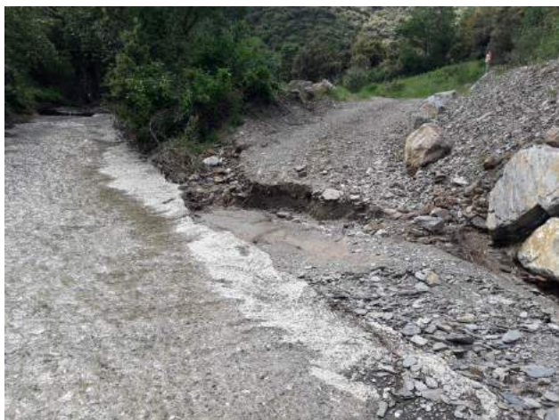
Photo 8 : Passage à Gué endommagé à proximité de la plateforme Marty (19/05/20)
