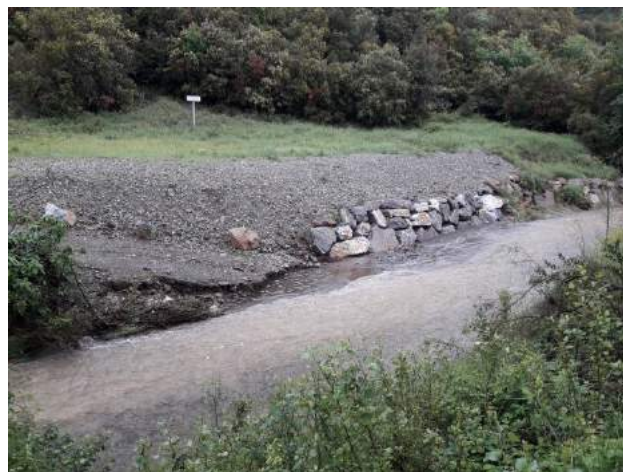
Photo 9 : Plateforme Marty après les pluies de mai 2020 (13/05/20)
