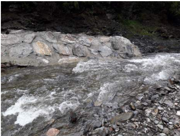
Photo 2 : Protection en enrochement en sortie de virage (13/05/20)
