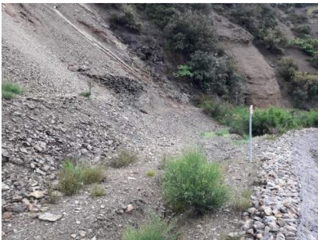
Photo 4 : Pas de glissement de la verse durant l'épisode pluvieux (13/05/20)
